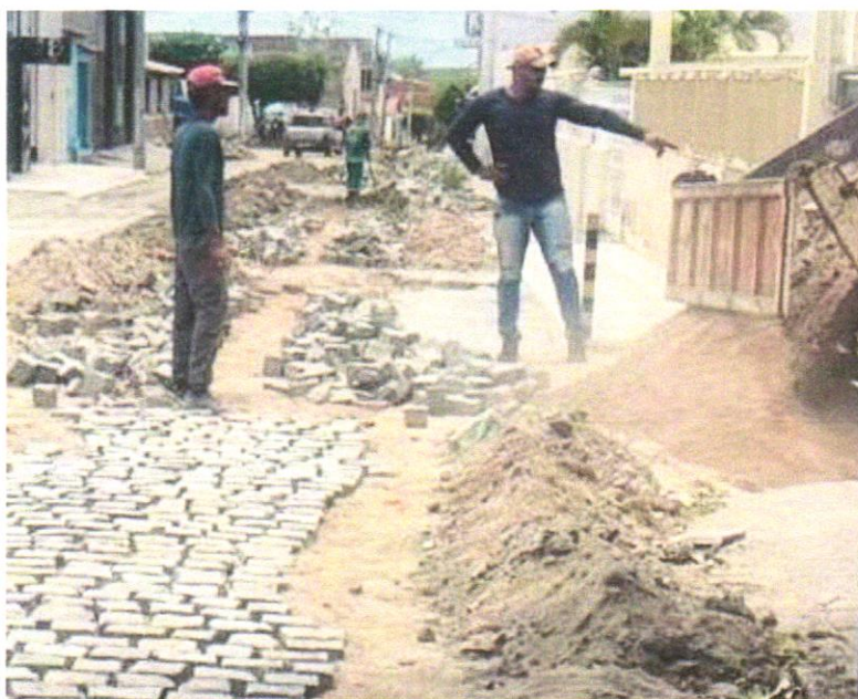
Foto 03 - ATERRO MANUAL COM SOLO ARGILLO-ARENOSO IMPORTADO E COMPACTAÇÃO MECANIZADA EM CAMADAS DE 0,20 M NO MÁXIMO
